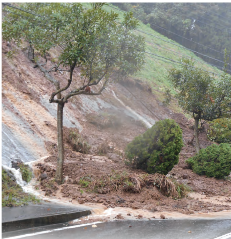
(写真は平成29年台風21号によるグリーンピア岩沼に向かう道路の土砂崩れ)
