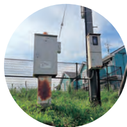
▲松ヶ丘マンホールポンプの制御装置
