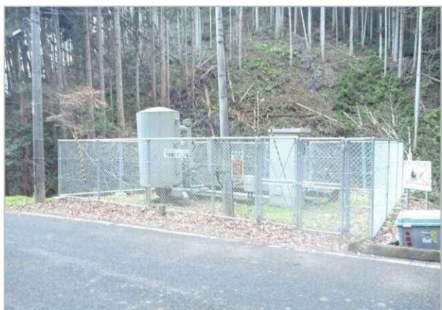
志賀第二ポンプ場
