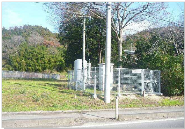
志賀第一ポンプ場
